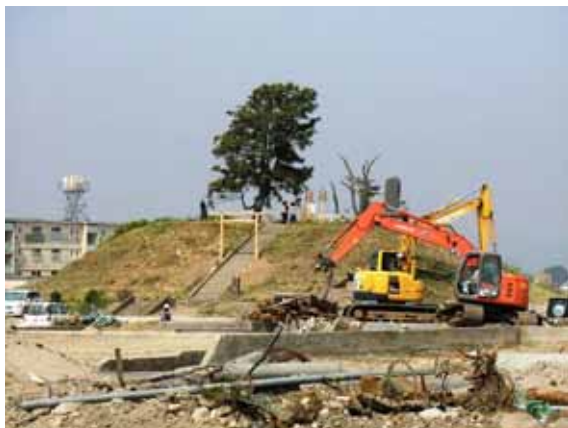
津波による被災状況（名取市閉上）
