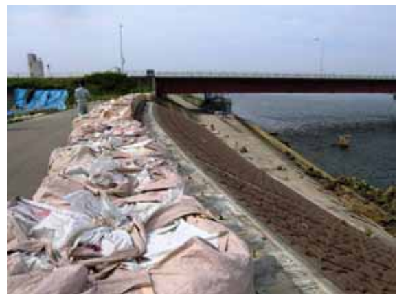
津波により流されたパラペット（阿武隈川河口付近）
