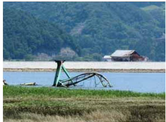
津波で落橋し流下したトラス橋(北上川)
