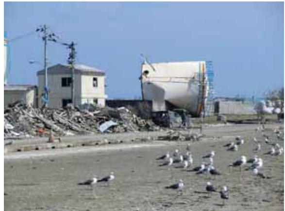
杭頭部(鋼管 700mm)で破壊された防潮堤。
