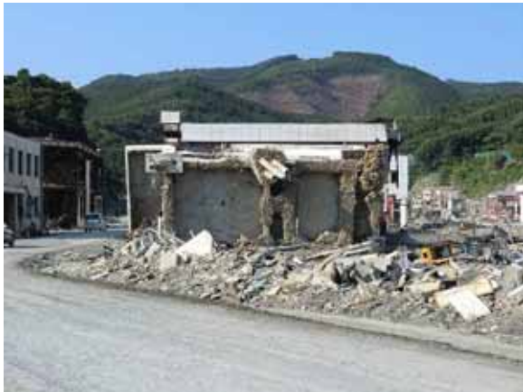
引き波により転倒した直接基礎の建物。
