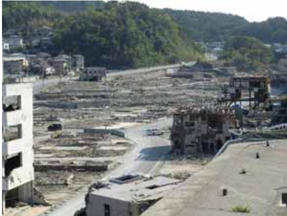
杭基礎が抜け出して転倒した駐在所。
