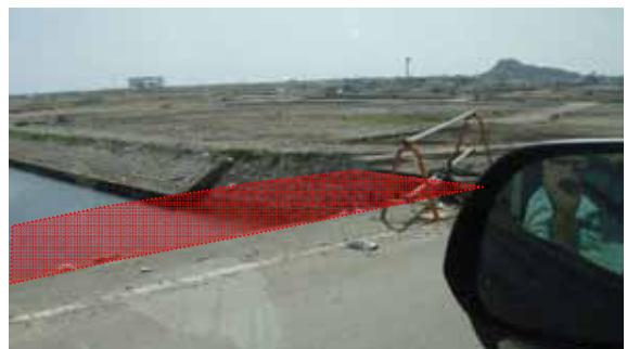
津波により主桁が流出している
