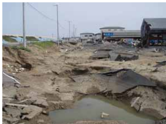
堤防法尻の洗掘
