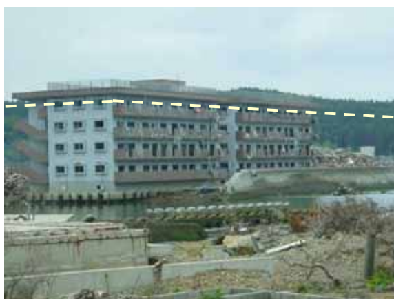
マンション4階に残された津波痕跡
