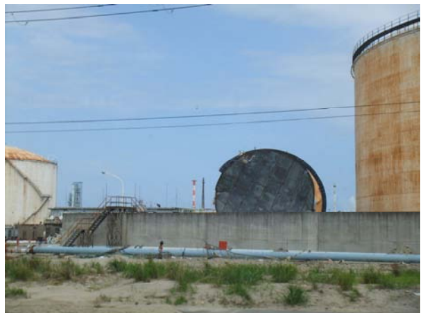
写真：地震による被害状況
