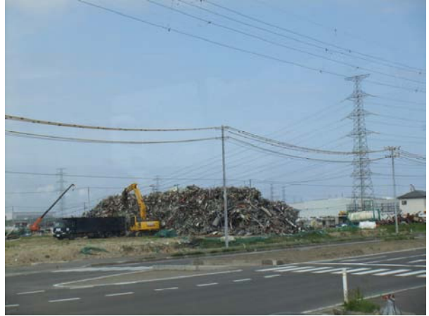
写真：瓦礫の状況
