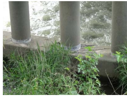
橋脚基礎コンクリートにも破壊が見られた。
