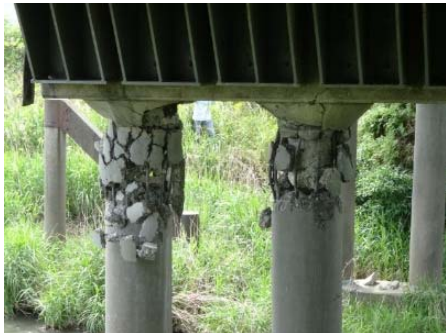
本橋はパイルベント橋脚である。橋脚の上部が破壊させている。
