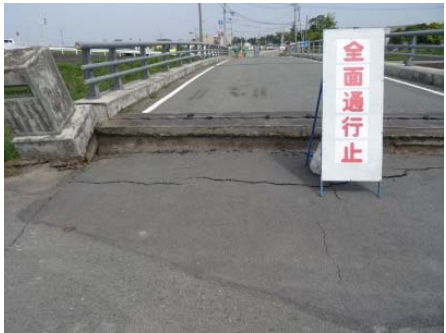
橋台背面の沈下により橋梁部と土工に 70cm 程度の段差が生じている。
