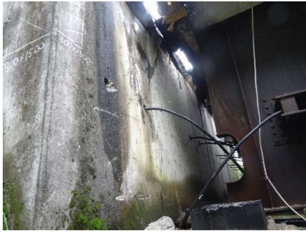
桁の移動量が大きく落橋防止装置が破断している。(奥側 120cm の移動量)
