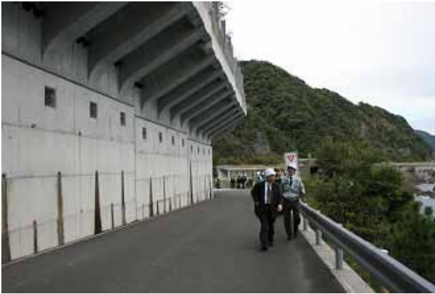
片持ち式ロックキーパー。サンドクッションを敷いたプレキャストコンクリート製の柵をグラウンドアンカーで地山に固定している。
